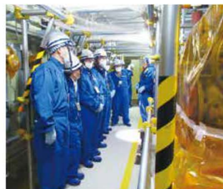
島根原子力発電所視察 (2号機高圧原子炉代替注水ポンプ)
